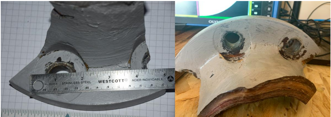
Figura 2. Fissura entre os orifícios de parafusos em uma seção de amostra de um flange de FRP
